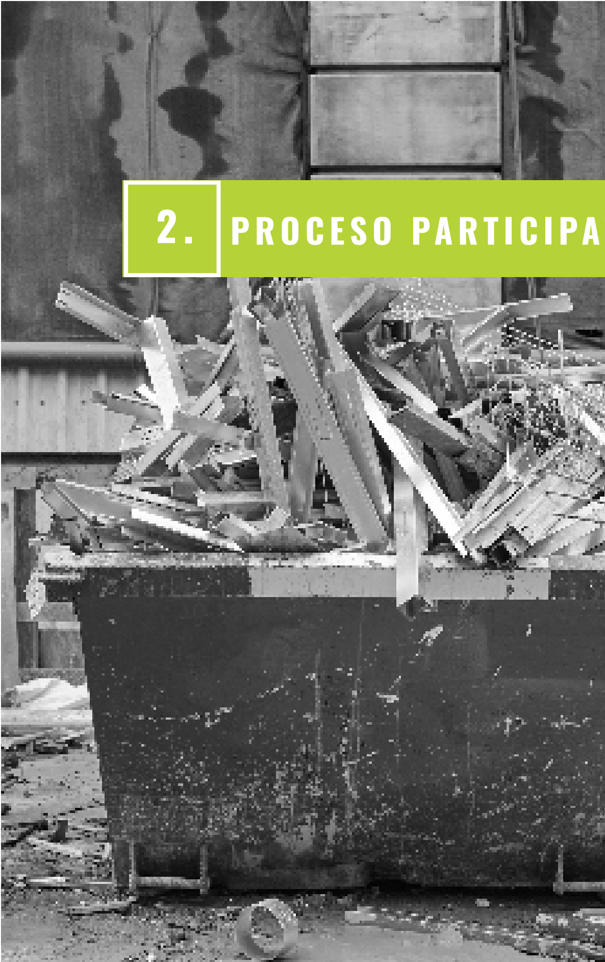
Figura 12: Removal of debris by ABBPhoto a través de EnvatoElements / Licencia de proyecto: Hoja de Ruta RCD 2035_Edición 2020 by Avanza Arquitectos.
