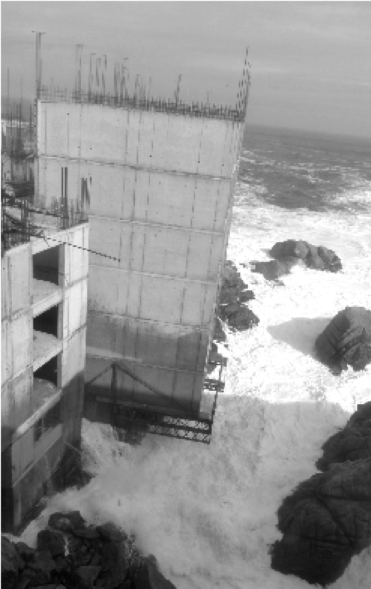
Figura 46: Marejadas inundando edificio. Gentileza de Alejandra Tapia.
