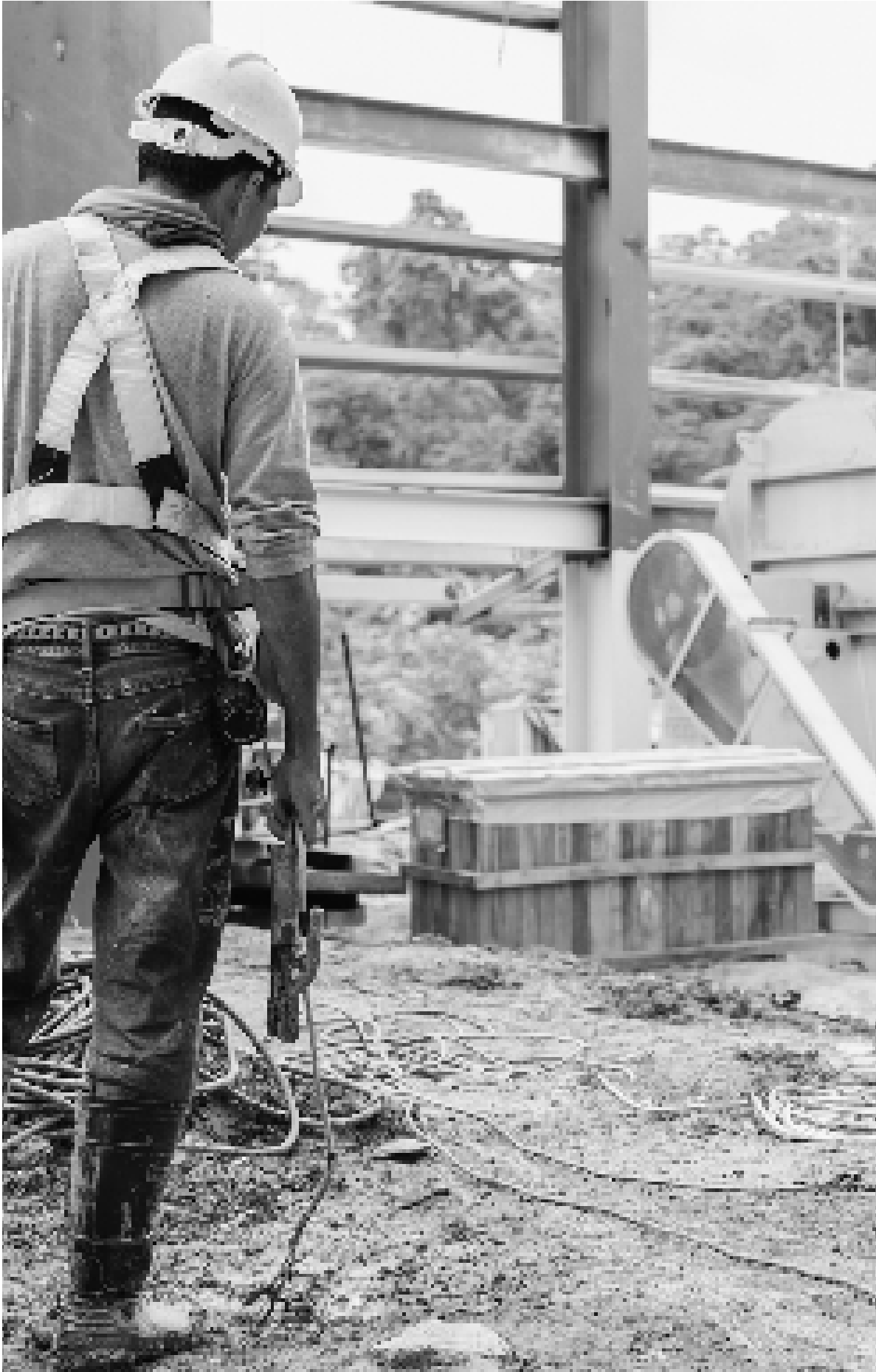
Figura 48: Safety first, geared up, & start work by Brandonann a través de Twenty20 / Licencia de proyecto: Hoja de Ruta RCD 2035_Edición 2020 by Avanza Arquitectos.
